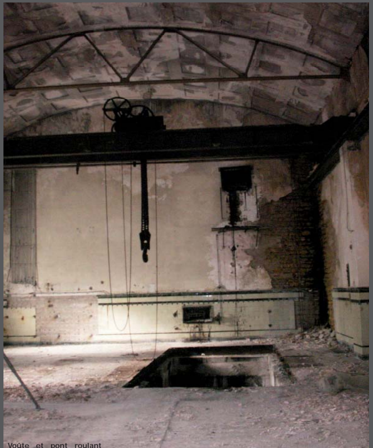
Voûte et pont roulant
